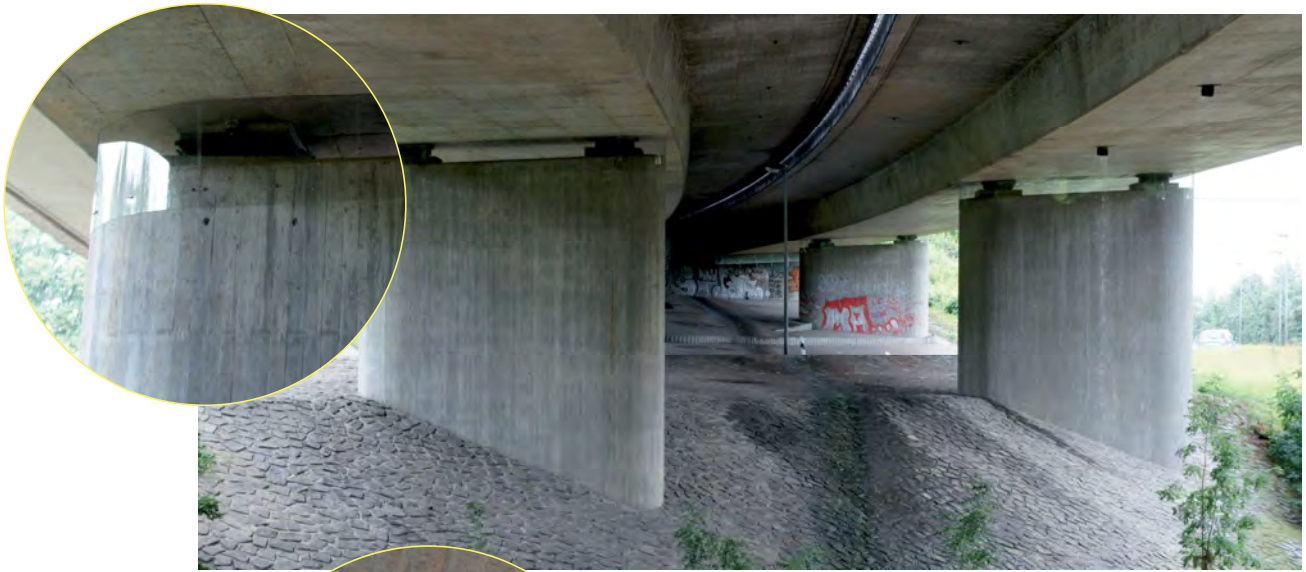
Brückenpfeilerschutz mit Makrolon-Platten
